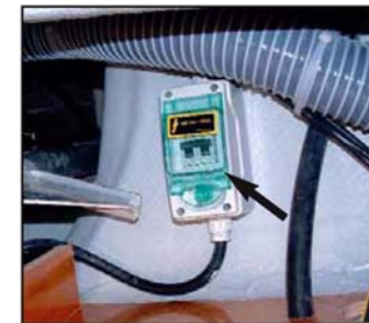
220 V BREAKER (Landmark 2)
